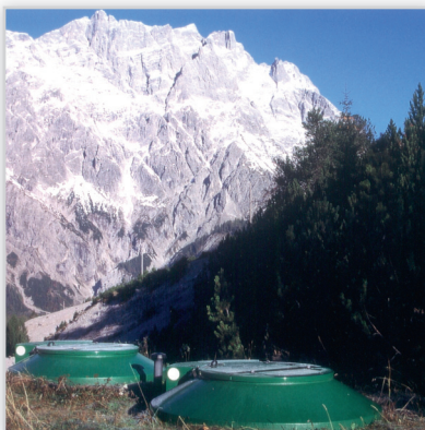
EKOFINN-POL, Oczyszczalnia ścieków BIOCLERE® dla schroniska górskiego w Alpach (Berchtesgaden, Niemcy). RLM: 55. Zastosowane urządzenia: osadnik wstępny, złożo biologiczne BIOCLERE® typ B55, złożo biologiczne BIOCLERE® typ B38, 2001.
