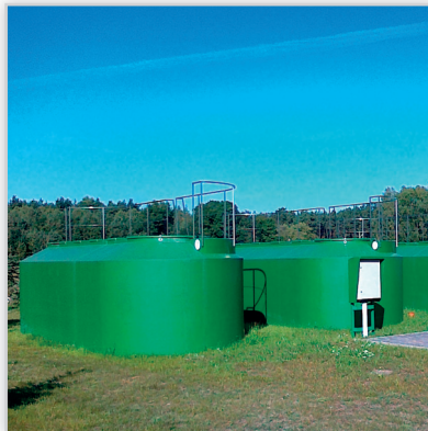
EKOFINN-POL, Oczyszczalnia ścieków BIOCLERE® dla miejscowości Łuszczanowice (woj. łódzkie). Przepustowość [m³/d]: 200. Zastosowane urządzenia: osadnik wstępny, złożo biologiczne BIOCLERE® typ B500 x 4, 2011.
