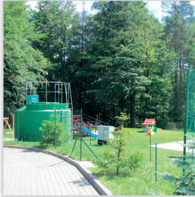
EKOFINN-POL, Oczyszczalnia ścieków BIOCLERE® dla osiedla Park w Małkowie (woj. pomorskie). RLM: 150. Zastosowane urządzenia: osadnik wstępny OW20, złożo biologiczne BIOCLERE® typ B180, 2007.
