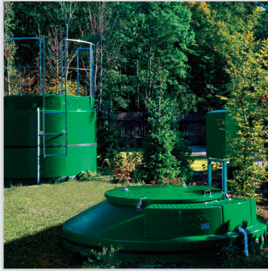
EKOFINN-POL, Oczyszczalnia ścieków BIOCLERE® dla Hotelu Młyn Klekotki (woj. warmińsko-mazurskie). RLM: 140. Zastosowane urządzenia: osadnik wstępny OW20, złożo biologiczne BIOCLERE® typ B95, złożo biologiczne BIOCLERE® typ B45B, 2004.
