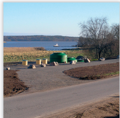
EKOFINN-POL, Oczyszczalnia ścieków BIOCLERE® dla Domu Spokojnej Starości Dalby (Uppsala, Szwecja). RLM: 95. Zastosowane urządzenia: osadnik wstępny, złożo biologiczne BIOCLERE® typ B95, złożo biologiczne BIOCLERE® typ B55, stopień chemiczny BIOCLERE® typ K2.9, 2011.
