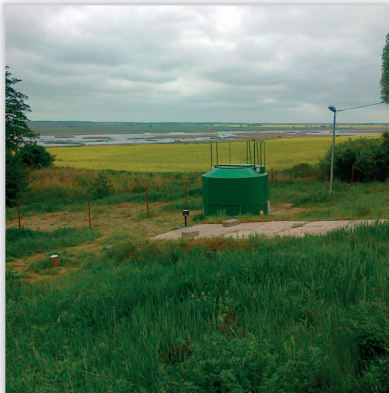
EKOFINN-POL, Oczyszczalnia ścieków BIOCLERE® dla miejscowości Pleśnik (woj. warmińsko-mazurskie). RLM: 110. Zastosowane urządzenia: osadnik wstępny OW20, złożo biologiczne BIOCLERE® typ B150, 2010.
